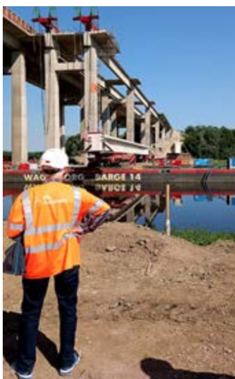
Der Träger wird mit dem Ponton vom Süd- zum Nordufer ganz langsam über die Hunte transportiert Foto: Dirk Hillmer
